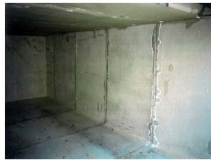
②漏水状況
