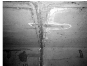
③漏水状況
