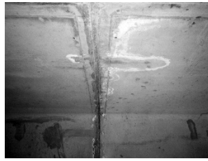
③漏水状況
