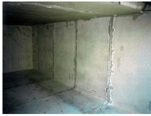
②漏水状況
