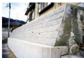
③コンクリート打設及び新設間知ブロック組積完了状
