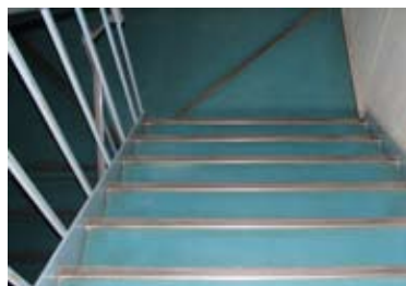
階段エポキシ塗床
