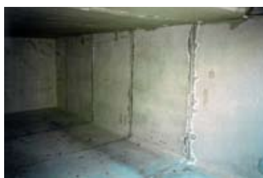
②漏水状況
