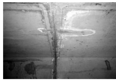
③漏水状況
