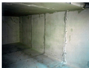
②漏水状況
