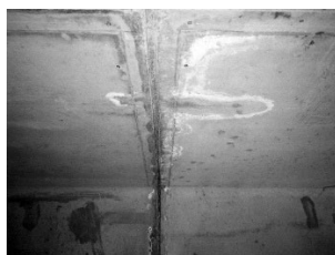
③漏水状況
